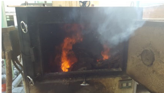
ボイラーによる加温状況
