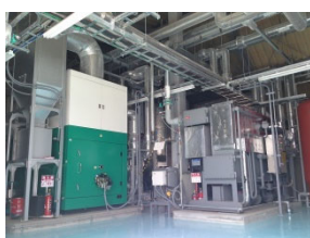
チップボイラー
