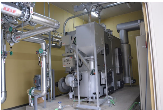
ペレットボイラー
