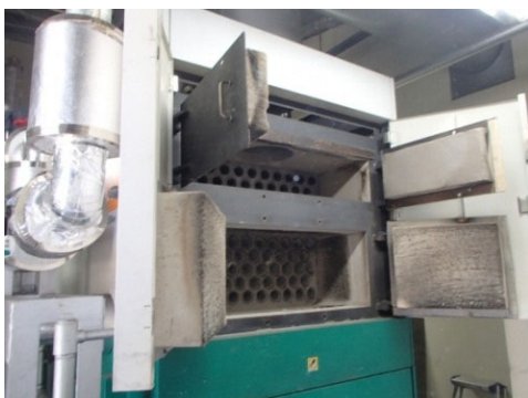
チップボイラー
