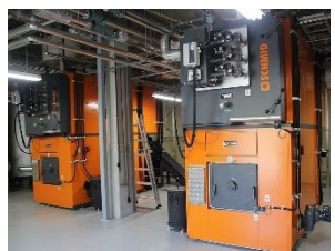
(木質バイオマスボイラー)
