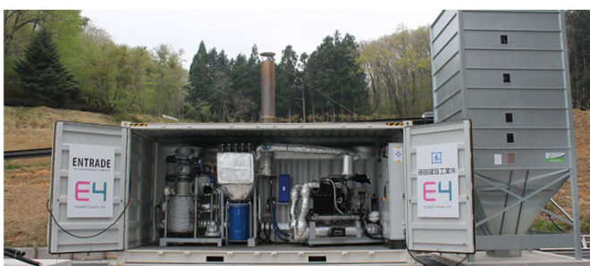
バイオマス発電熱電併給ユニットE4
