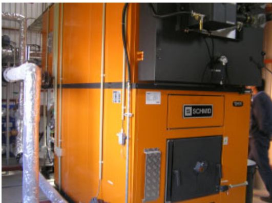
バイオマスチップボイラー
