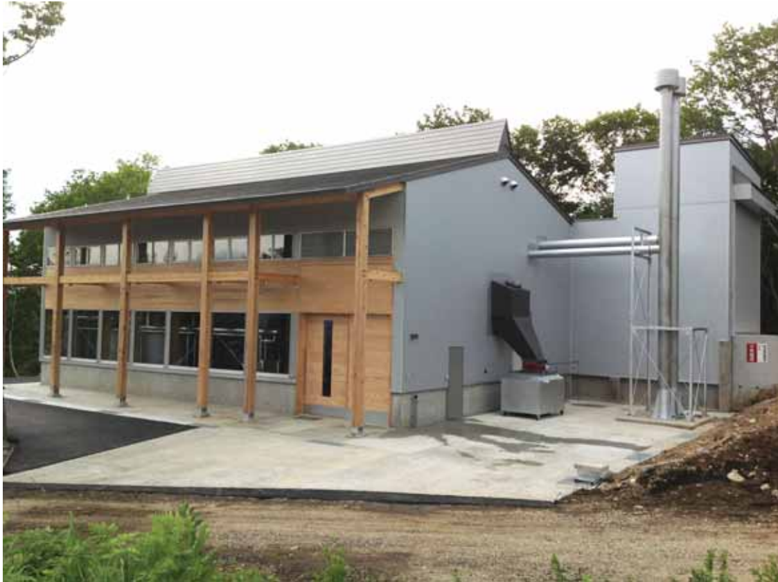
環境ショーケース型機械室
