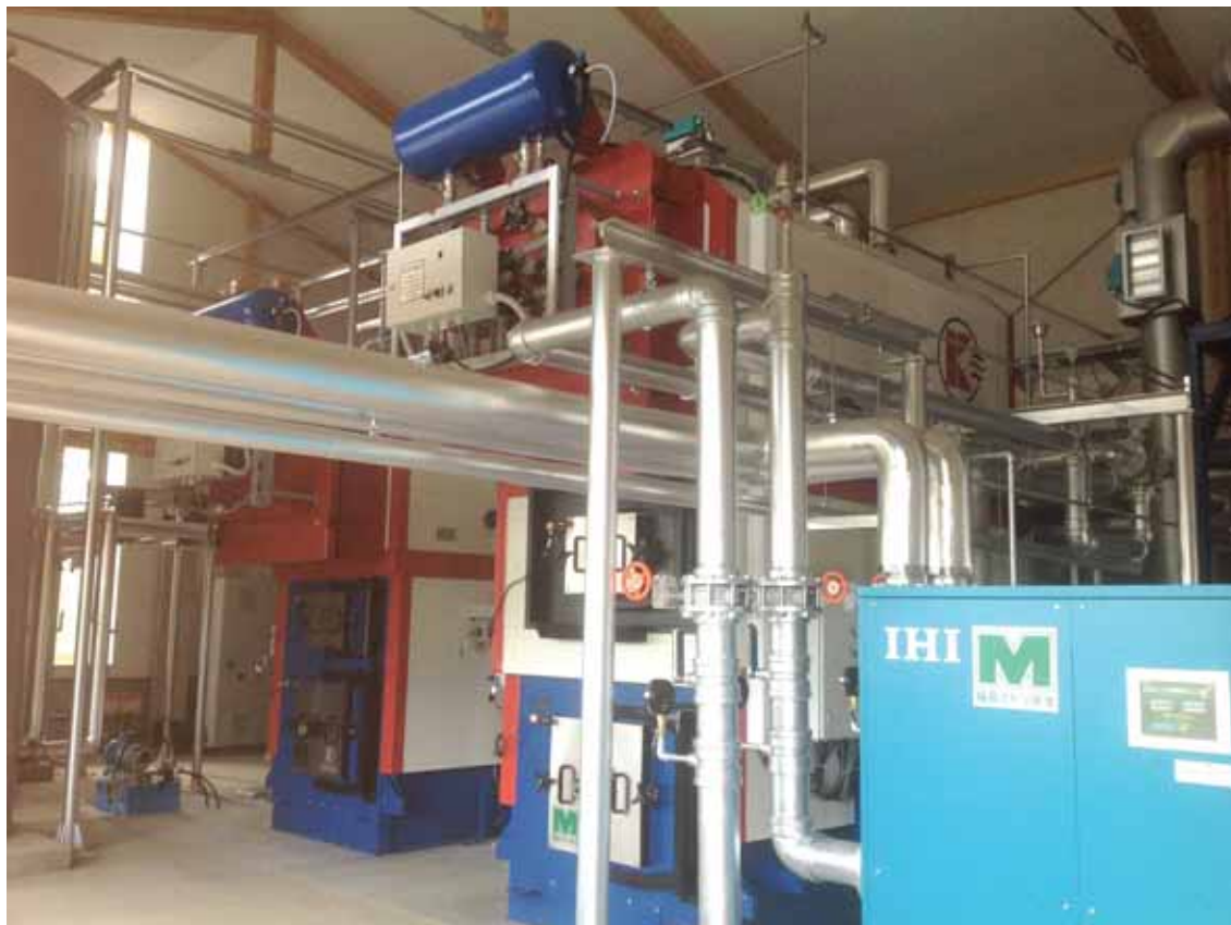
木質バイオマスボイラ、小型バイナリー発電機
