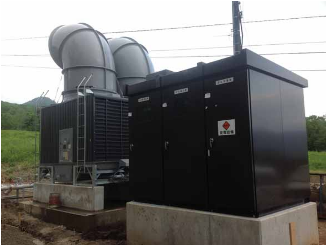
冷却塔、キュービクル
