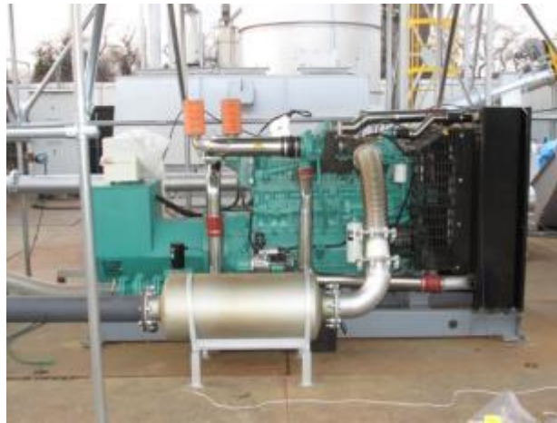
図 15. ガスエンジン
