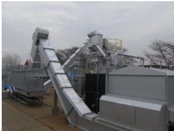
図 8. 乾燥機排出コンベア
