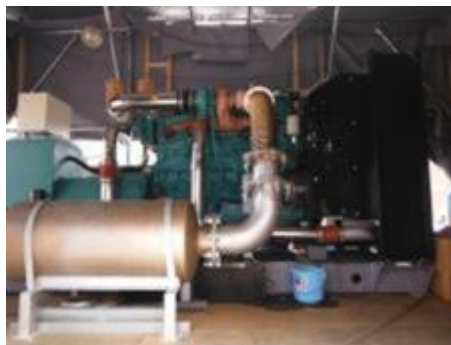
図 19. ガスエンジン
