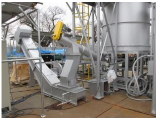
図 11. 炭化物排出コンベア
