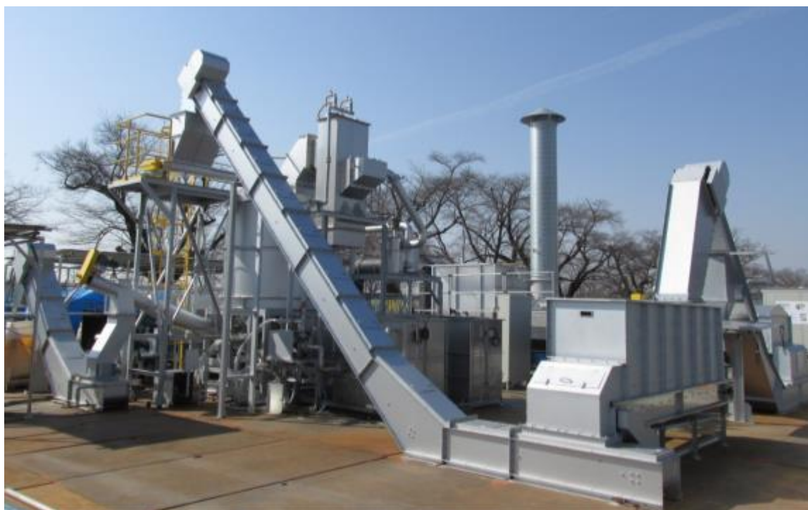
図 2. 木質バイオマスガス化発電施設
