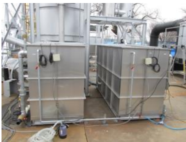
図 13. 酢液タンク・オイルタンク
