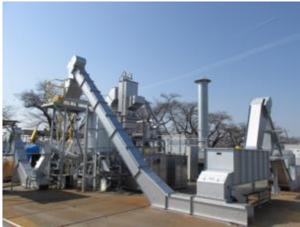
図 5. 木質バイオマスガス化発電施設の外観
