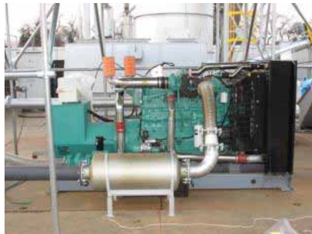
図 31. ガスエンジン
