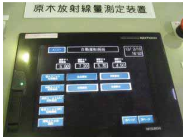
図 52. 操作盤の表示
