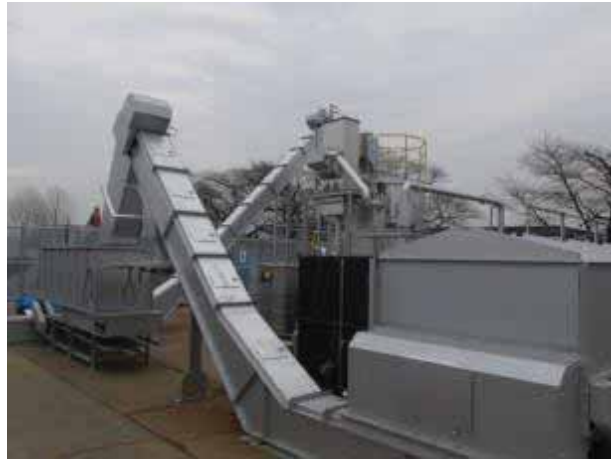
図 24. 乾燥機排出コンベア
