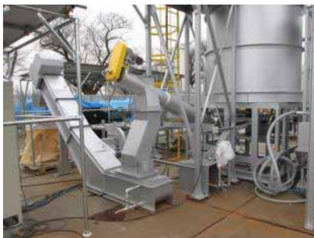
図 27. 炭化物排出コンベア
