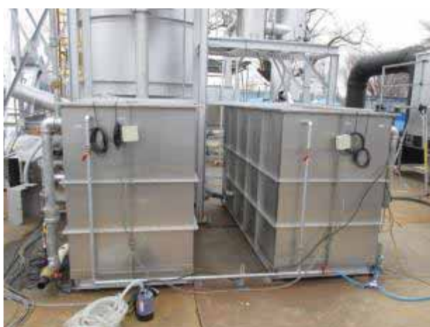
図 29. 酢液タンク・オイルタンク
