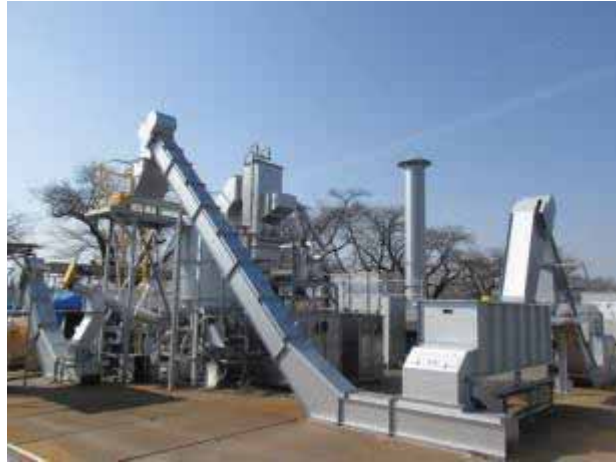
図 21. 木質バイオマスガス化発電施設の外観
