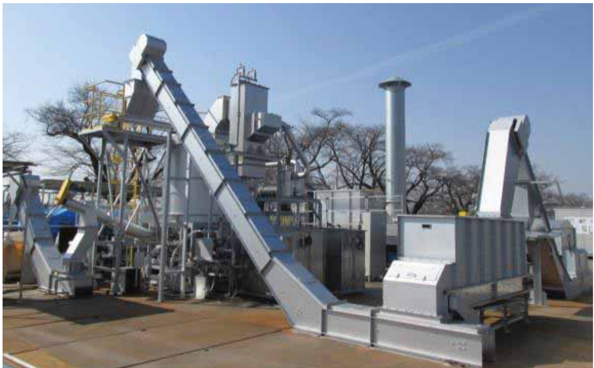
図 2. 木質バイオマスガス化発電施設
