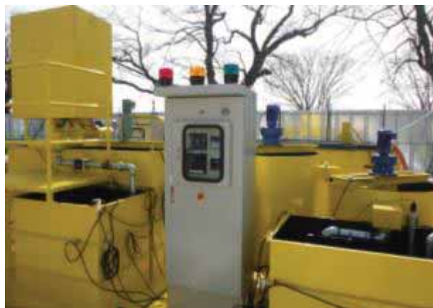
図 83. 汚染水処理プラントの外観
