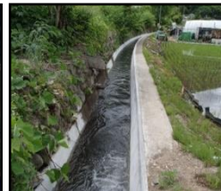
老朽化した用水路の整備・更新
