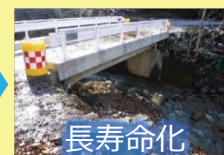
橋梁の老朽化
