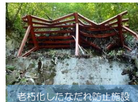
老朽化したなだれ防止施設
