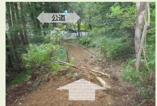
【歩道崩落により流出する土砂】 今後の降雨等により被害が拡大すれば、土砂が公道に流出するおそれ。
