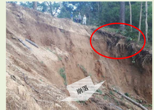
【損壊した試験林】 周囲の樹木の根が浮いた状態であり、今後さらに被害が拡大する恐れ。
