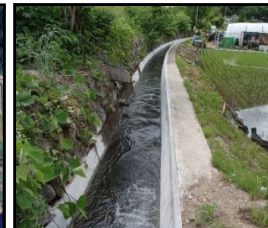
老朽化した用水路の整備・更新
