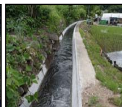
老朽化した用水路の整備・更新
