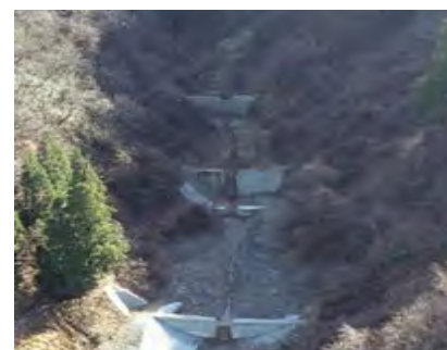
小規模な治山ダムを 階段状に配置
