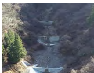
小規模な治山ダムを階段状に配置
