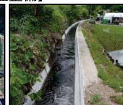
老朽化した用水路の整備・更新
