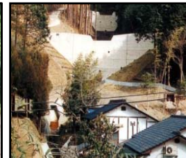
治山施設による山地災害の未然防止
