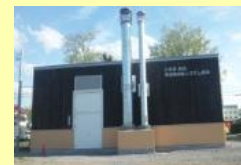
木質バイオマスボイラー(700kW他)
