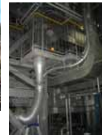
木質バイオマス スボイラー
