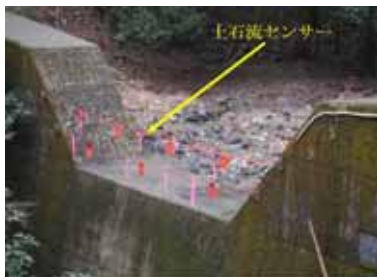
既存の治山施設に設置した土石流センサー
