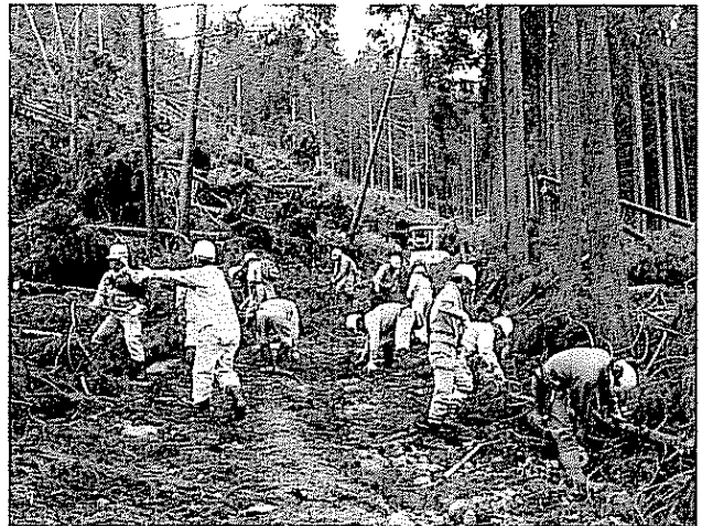
平成16年11月14日（日）、岡山県林政課の呼びかけで集まったボランティア66名が、台風23号で被災した県北東部勝田郡奈義町の林道滝谷線で倒木の撤去作業をおこなった。
