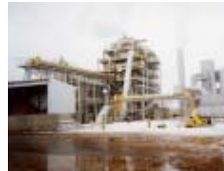
木質資源を利用しているエネルギー施設
