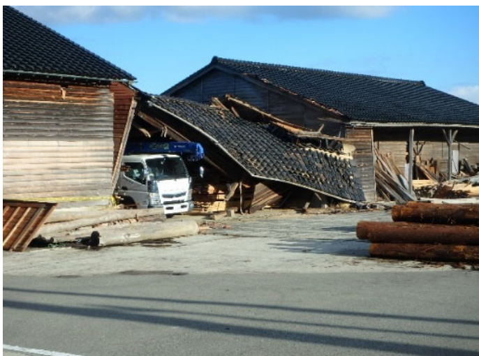
木材保管庫の倒壊（七尾市）
