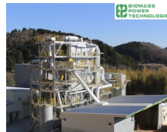
松阪木質バイオマス発電所 (1,990kW:FIT認定)
