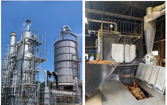
バイオマスボイラー導入や技術開発による乾燥プロセスの省エネ化
