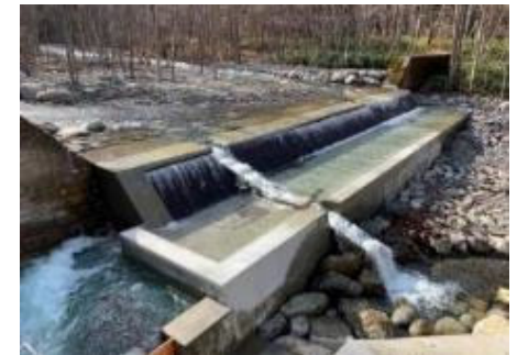
国有林野を利用した小水力発電所
