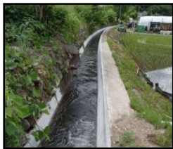
老朽化した用水路の整備・更新
