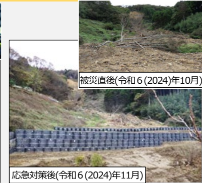
土砂流出箇所の応急対策 (石川県珠州市 民有林)
