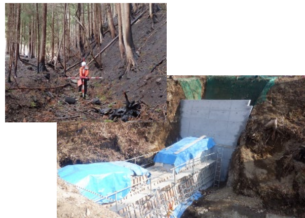
次期降雨等による土砂・流木流出を防止 (岩手県大船渡市)
