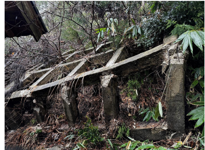
能登半島地震によるのり枠工の被害
