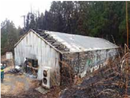
菌床しいたけ栽培ハウスの被災状況
