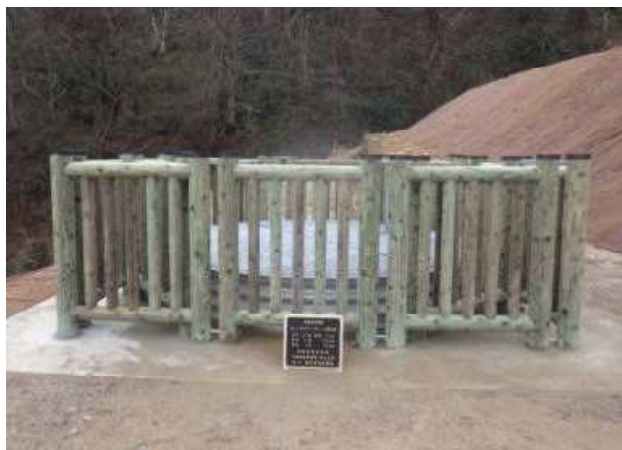
集水井安全柵（新潟県関川村） [国有林治山事業]
