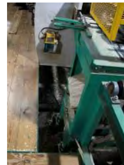
開口部がある 足場が不安定
