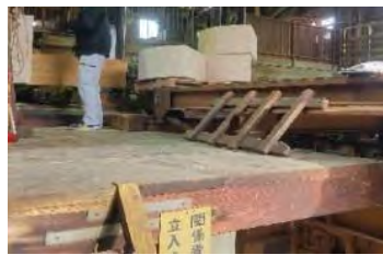
転落防止柵の未設置
