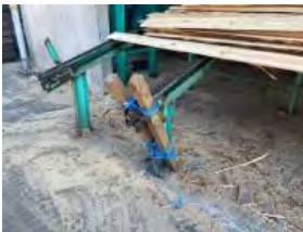
壊れた状態 応急処置のまま
