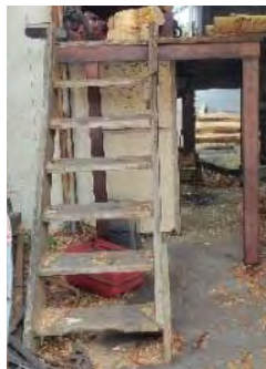
手摺りの未設置
