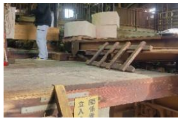
転落防止柵の未設置
