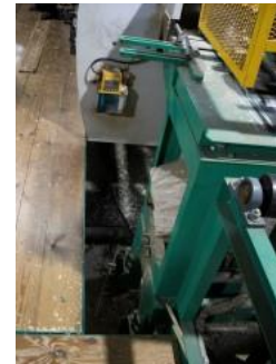
開口部がある 足場が不安定
