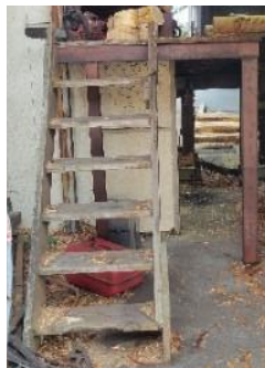
手摺りの未設置
