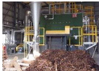
木質資源利用ボイラー
