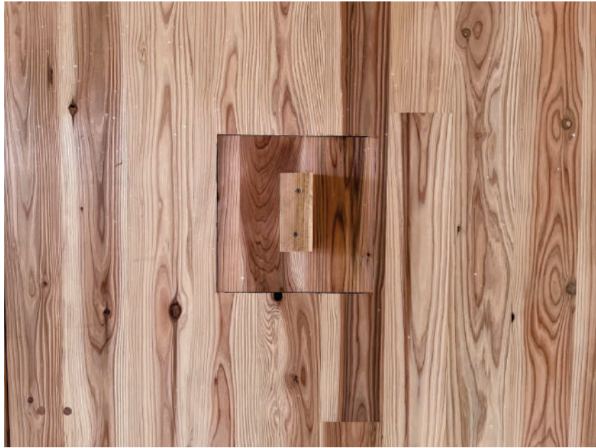
点検口（内部から点検が可能）
