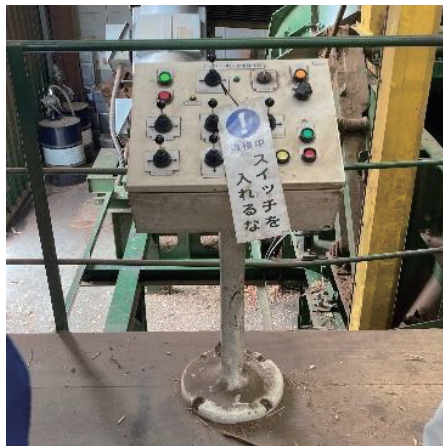
機械の点検中の掲示
