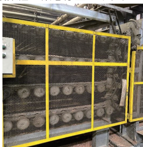
巻き込まれ防止のためのカバー設置
