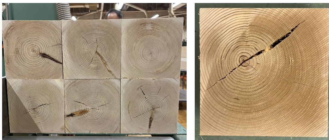
写真 1-3-③ 試験体の切断面に見られた節と内部割れ
