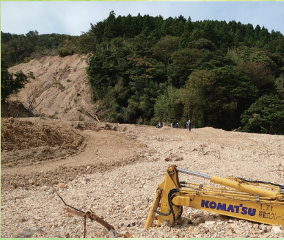
崩壊土砂と重機の埋没(珠洲市大谷町)
