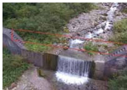
治山ダムに設置した土石流センサー
