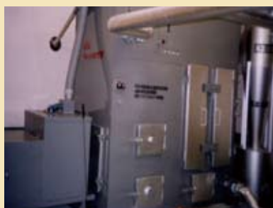
公共施設のボイラー
