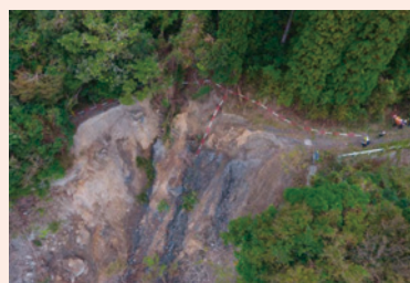
ドローンを活用した被災状況調査
