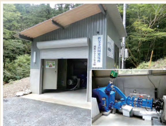
▲ マイクロ水力発電所
