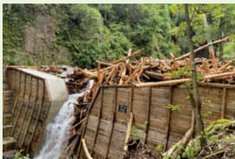
流木捕捉式治山ダムが流木や土砂を捕捉（熊本県球磨村、令和2年7月豪雨）
