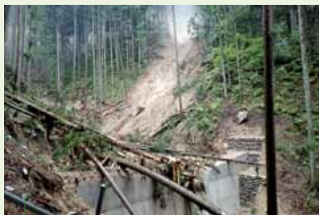
治山ダムが土砂や流木を捕捉（岐阜県下呂市、令和2年7月豪雨）
