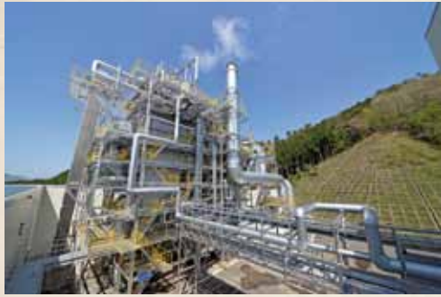
バイオマス発電所
