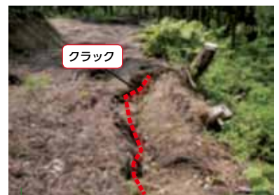
雨水の侵食により亀裂の入った路肩
