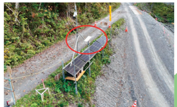
スターリンクを設置し通信環境確保
