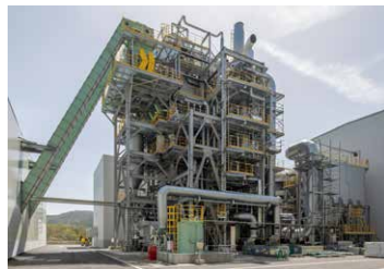
飯館みらい発電所（福島県飯館村） （写真提供：飯館バイオパートナーズ株式会社）
