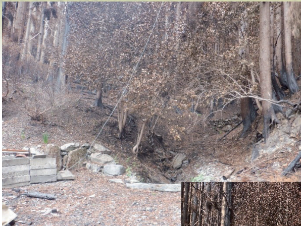
応急対策対策前
