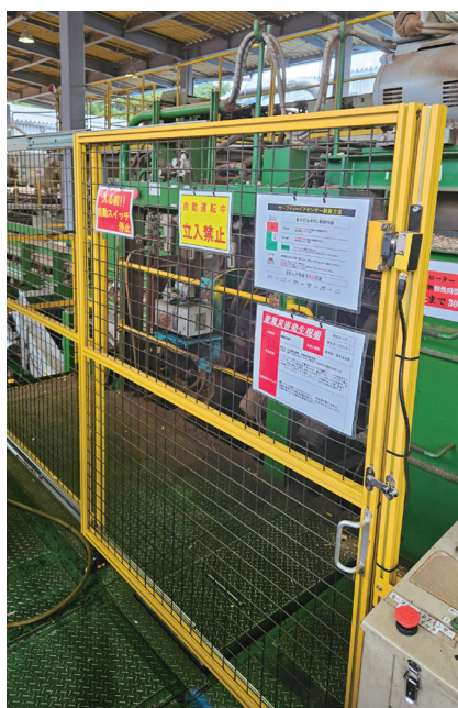
安全柵とインターロック装置(柵の扉を開けると機械が自動的に停止)
