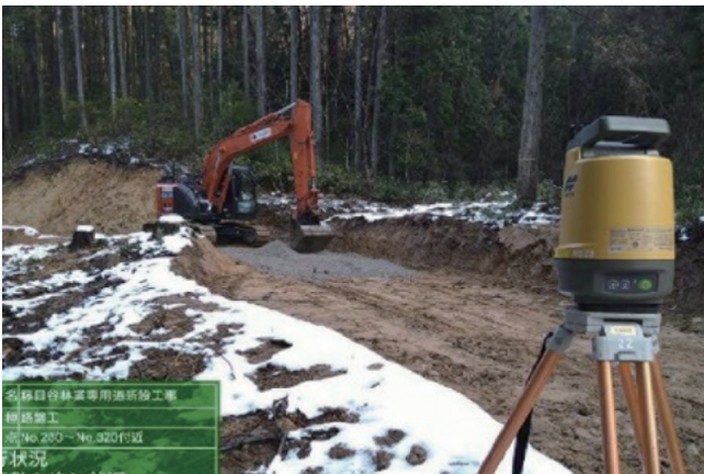
自動追尾式トータルステーションを活用したICT建設機械による施工
