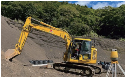
自動追尾式トータルステーションを活用したICT建設機械による施工
