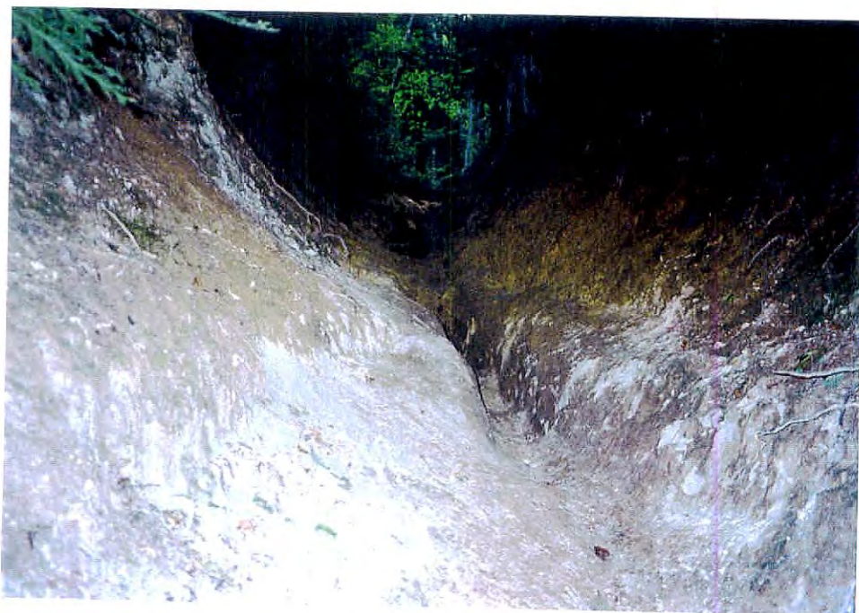
写真-101 歩道の洗掘状況
